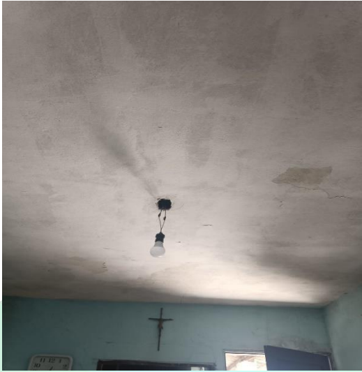
LÂMPADA QUEIMADA E TETO COM UMIDADE
