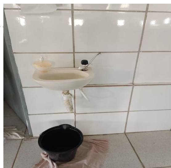
PIAS COM VAZAMENTO
