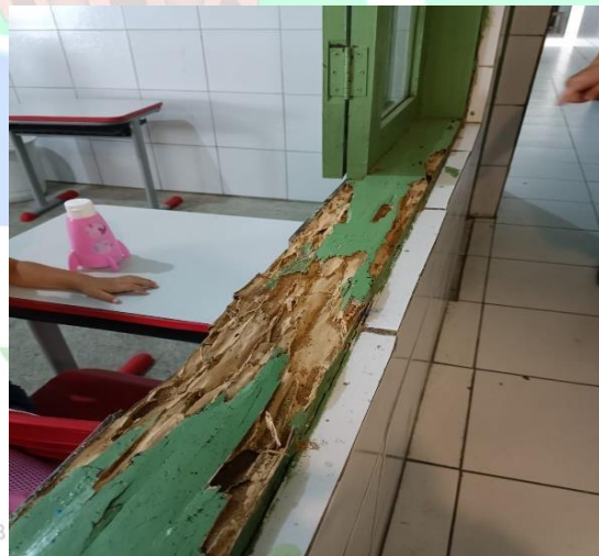
JANELAS E PORTAS COM CUPIM
