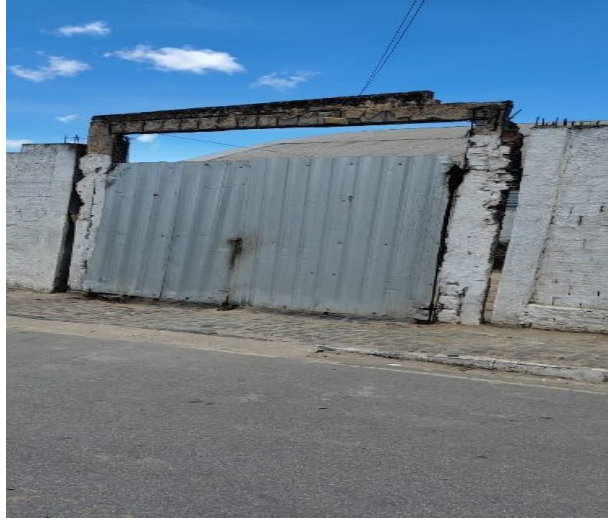
Portão lateral improvisado
