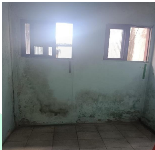
PAREDES INTERNAS COM SALINA E MOFO
