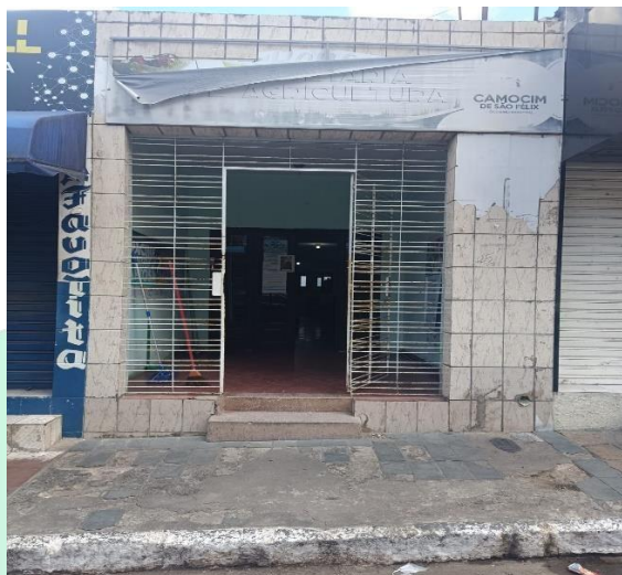
PLANCA DANIFICADA E PORTÃO ENFERRUJADO
