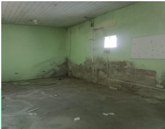
PAREDES INTERNAS COM SALINAS E MOFO
