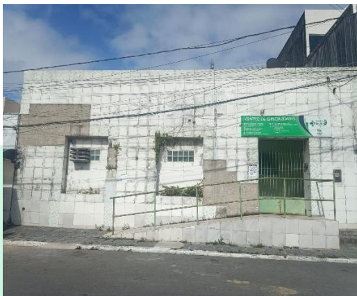
REVESTIMENTO DA PAREDE DESPLACANDO
