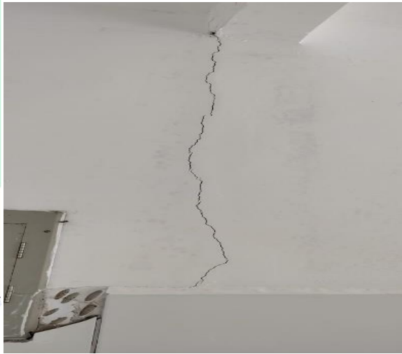
Trinca em alvenaria
