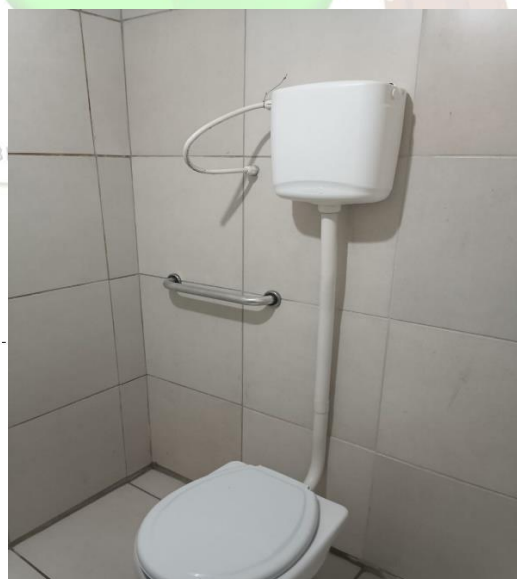
CAIXA DE DESCARGA COM VAZAMENTO
