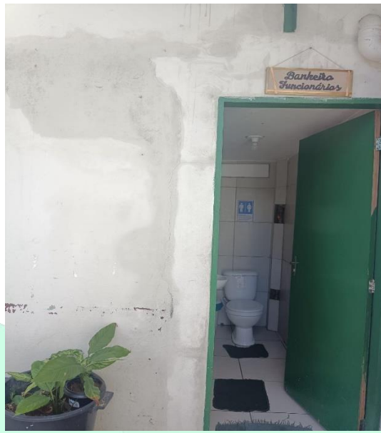
PAREDE COM IFILTRAÇÃO DEVIDO A CAIXA
