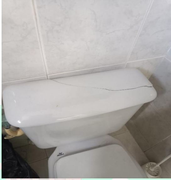
CAIXA ACOPLADA COM DEFEITO
