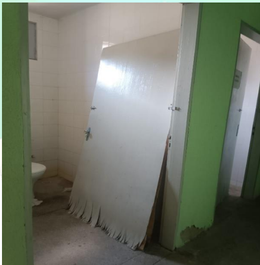
PORTAS QUEBRADAS OBS: MANUTENÇÃO DA COBERTA E ELÉTRICA
