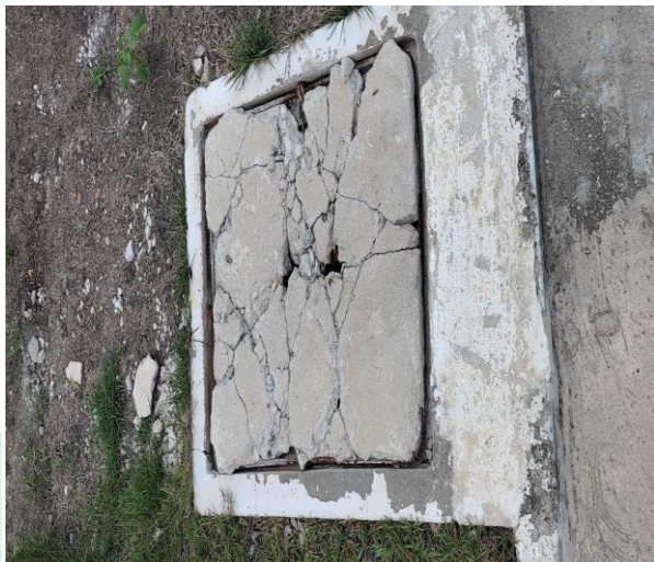
Tampa de cisterna deteriorada
