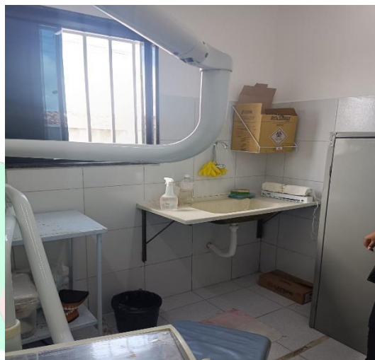
VAZAMENTO DA PIA NA SALA DO DENTISTA
