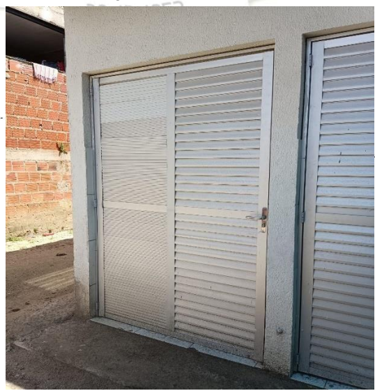
PORTAS E FECHADURAS COM PROBLEMAS
