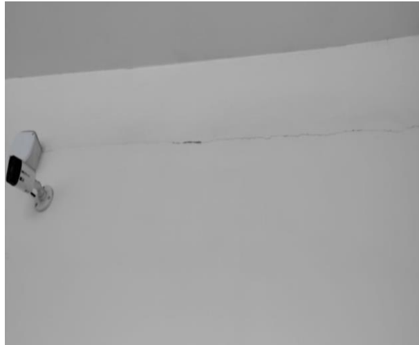
Fissura de ligação
