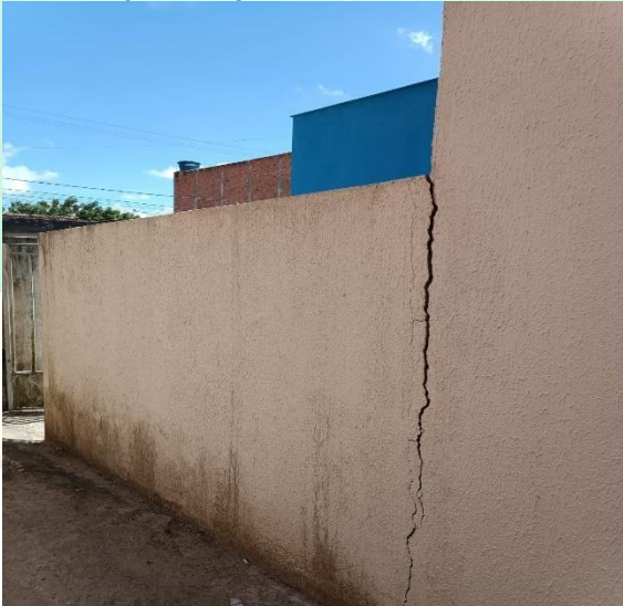
MURO EXTERNO EM RACHADURAS
