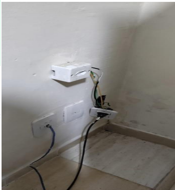
Instalação elétrica exposta
