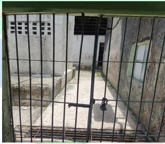
PAREDES EXTERNA E GRADES ENFERRUJADAS
