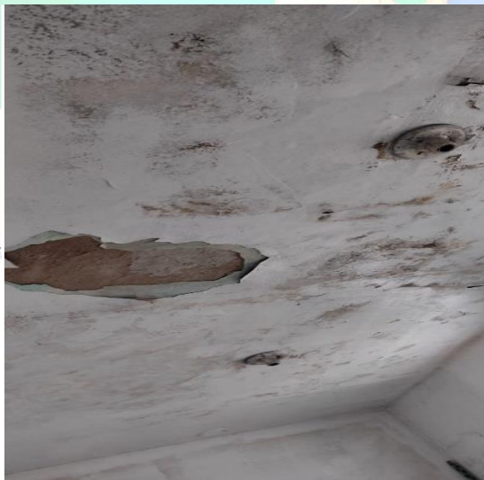
Infiltrações em laje
