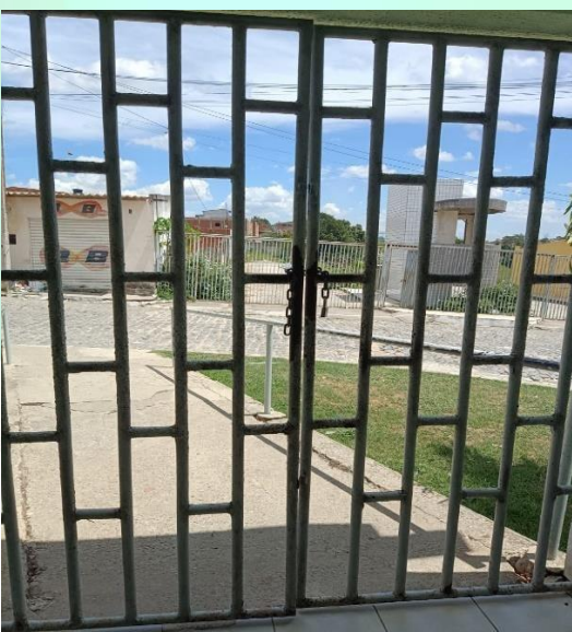
PORTÃO E GRADES ENFERRUJADAS
